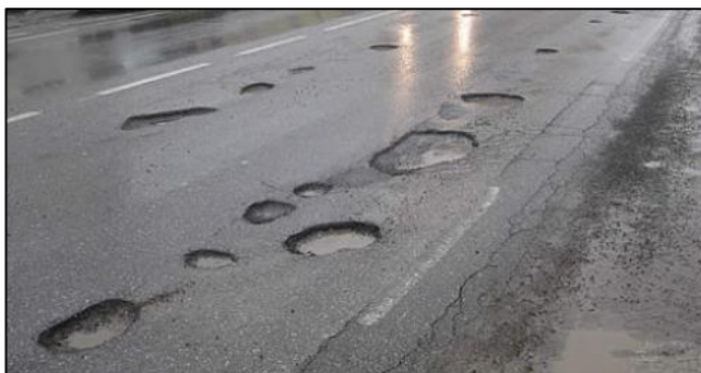
Strade con pavimentazione ammalorata
