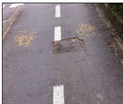
Piste ciclabile con pavimentazione ammalorata
